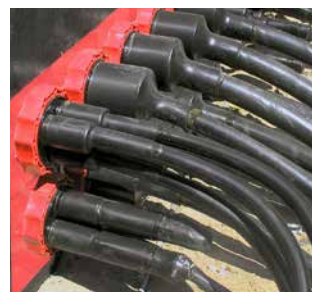
Entrée de poste de transformation : câbles basse tension étanchéifiés avec HSI90 D1x75 WS et HSI90 D3x32 WS
