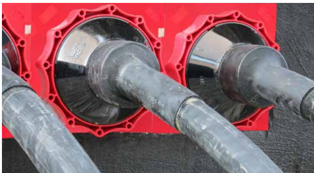
Entrée de station : câbles basse tension étanchéifiés avec HSI150 D1x80 WS
