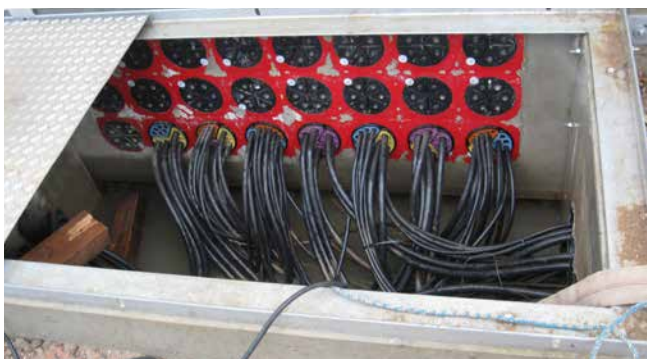
HSI150 – Passages étanches avec étanchéification SEGMENTO de lignes de commande dans une cabine de distribution
