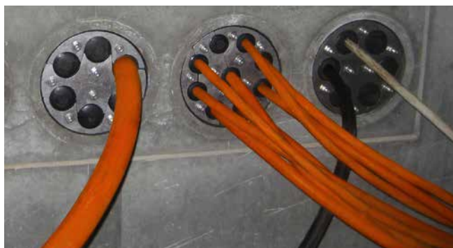
HRD150 SG intégré dans des fourreaux en fibrociment
